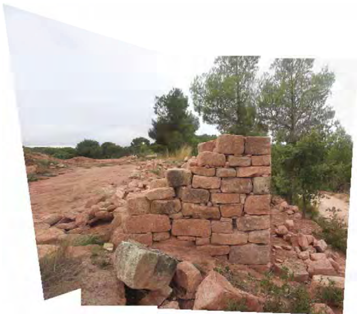
Façana Nord Est – Àmbit inferior al costat del camí - No hi ha cimentació de blocs de formigó
